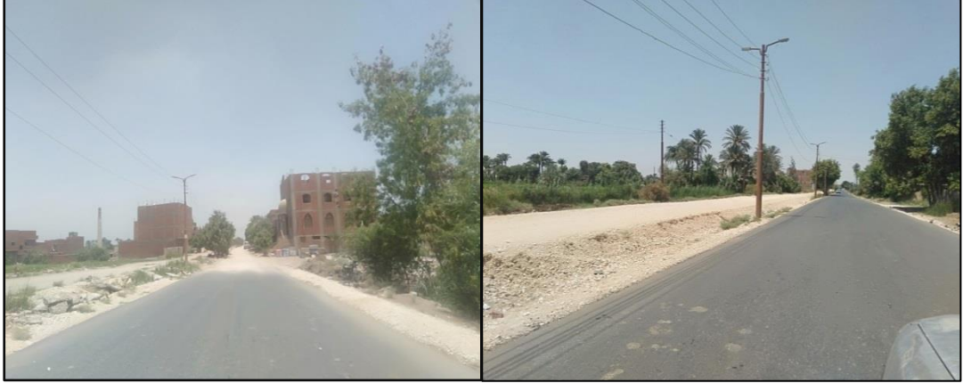
صورة (٥) عدم اكتمال رصف الطرق (طريق سنورس/بيهمو)
